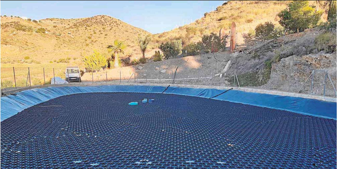
'Widgets' -hexágonos de plástico- fabricados por la firma murciana Tetnimat, alineados sobre una instalación de riego de Los Arejos (Águilas) para ahorrar agua. :: AMBIENTE EUROPEO
